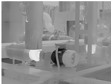
Figure 3-3 Exemple de noir chaud
